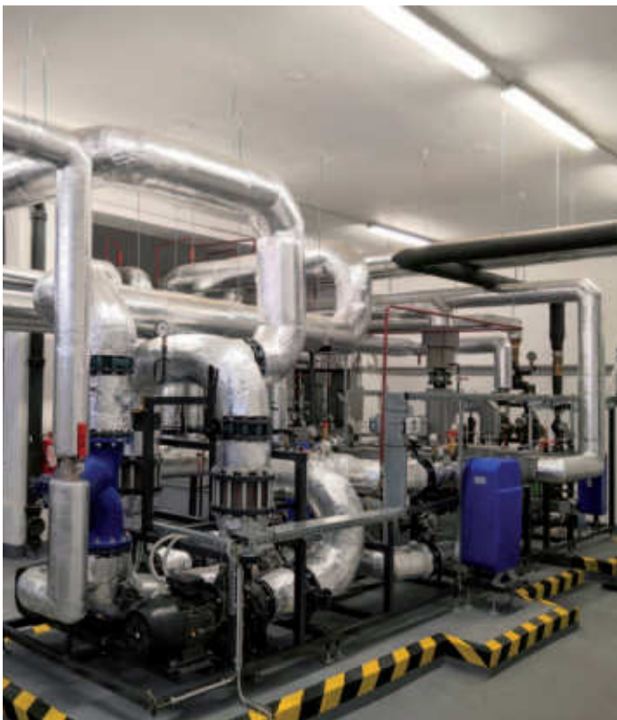
Zmodernizovaná výmenníková stanica Linčianska 4
