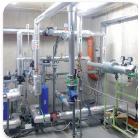
Nová výmenníková stanica v bytovom dome ARBORIA
