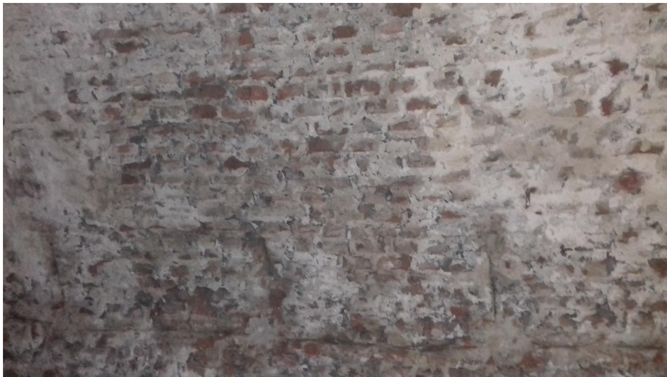
Obr č. 6: Približný rozsah otlčenia omietok a cementovej stabilizácie
